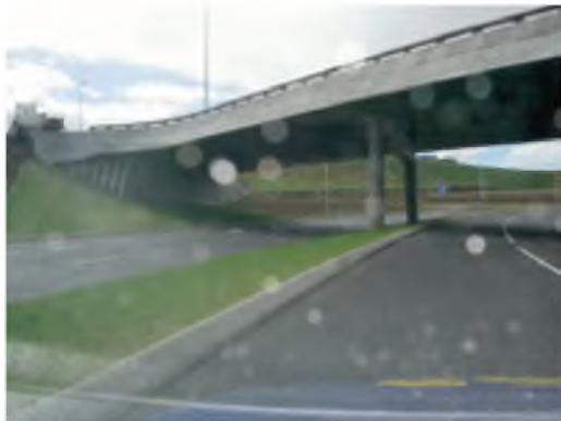
Ekkert vegrið er til að varna ákeyslu á brúarstólpana.
