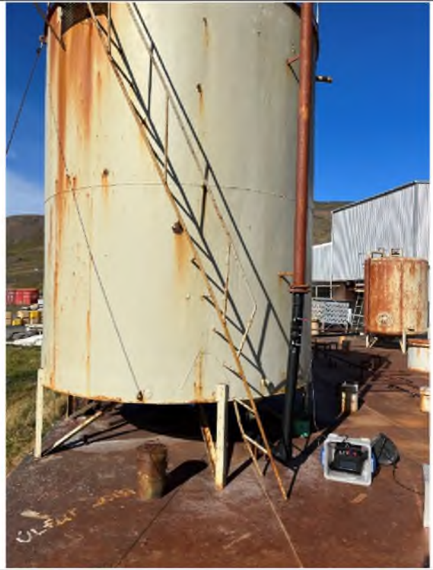
MYND 2 Rennismæling á inntaksröri í fitugildru
