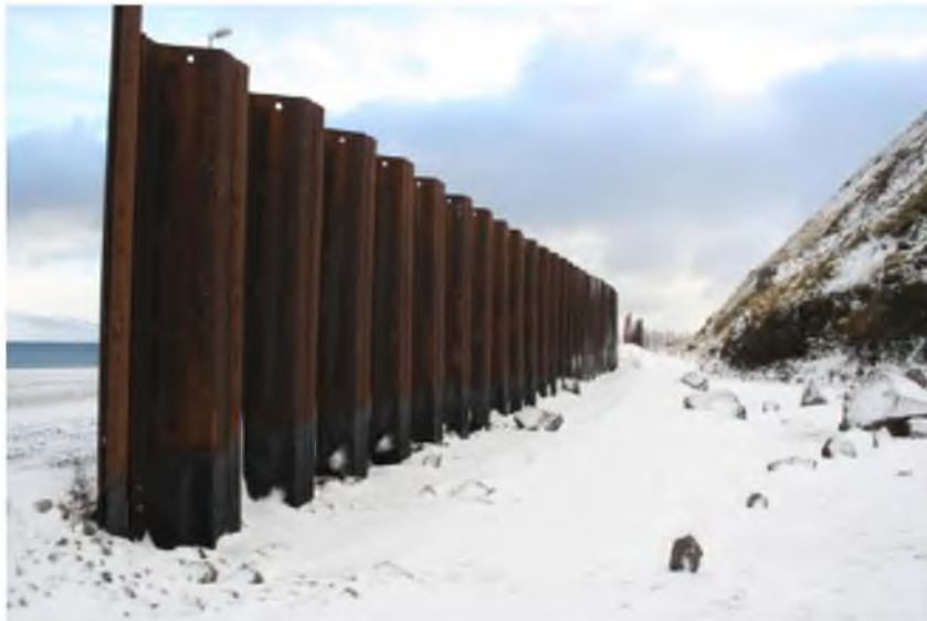
Mynd 15. Stálþil notað sem snjóflóðavörn við Óshlíðarveg. Vegskápurinn er hægra megin á myndinni. Ljós. Árni Jónsson 10/2005.
