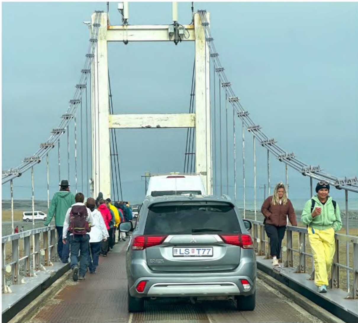
Mynd frá 2025 af brúnni yfir Jökulsá á Breiðamerkursandi: Gárungarnir tala um að brúin sé umferðarþyngsta göngubrú landsins. Það er aðeins tímaspursmál hvenær alvarlegt slys verður á brúnni.
